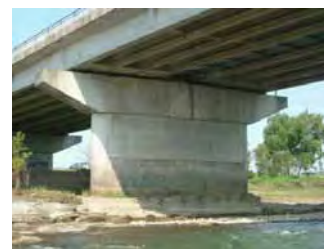
写真-1 洗掘による護岸の浮き上がり（上） 橋脚の根入れ不足（下）
