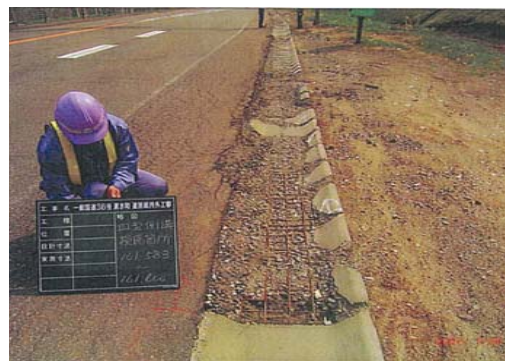
写真-1 既設皿形側溝の劣化状況
