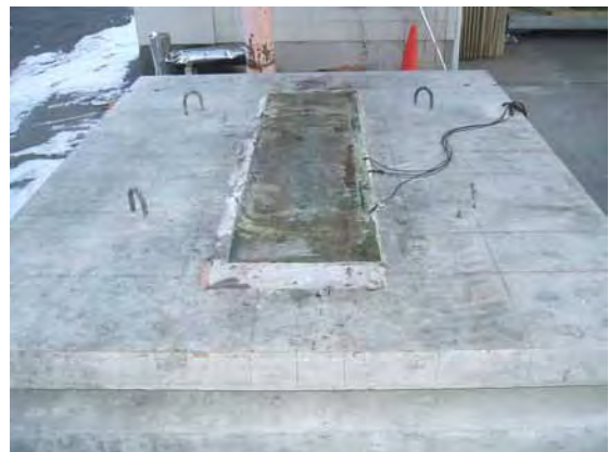
写真-5 実験終了時床版上面状況
