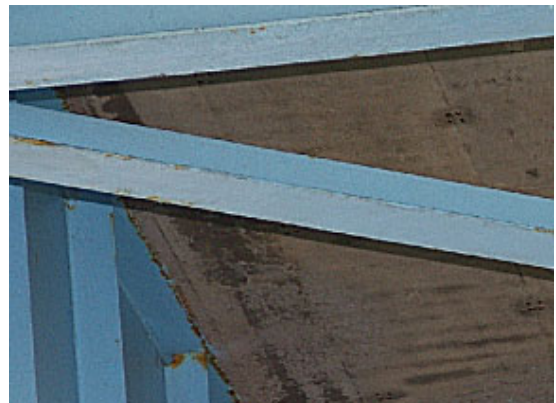
写真-2 横構の状況写真 (「増塗り1層」さび発生評価：0.03%)
