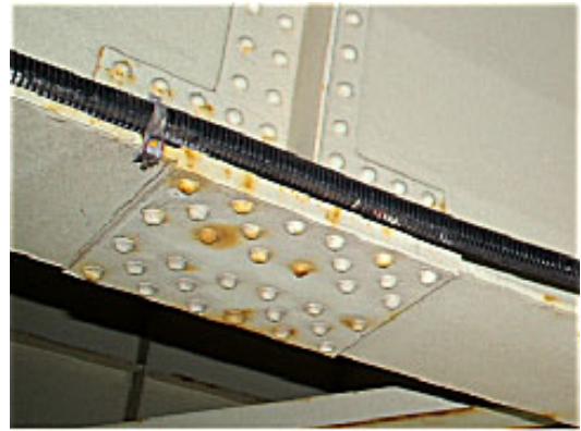
写真一5 ボルト継手部の状況写真 （「標準」さび発生評価：0.1%）
