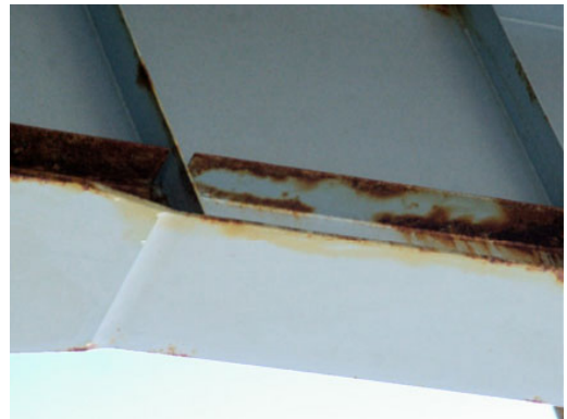
写真一7 エッジ部の状況写真 （「標準」さび発生評価：3%）
