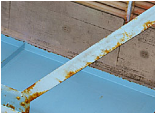
写真-1 横構の状況写真 (「標準」さび発生評価：0.1%)
