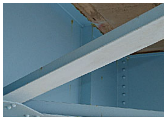
写真-4 横構の状況写真 (「超厚膜」さび発生評価：0%)
