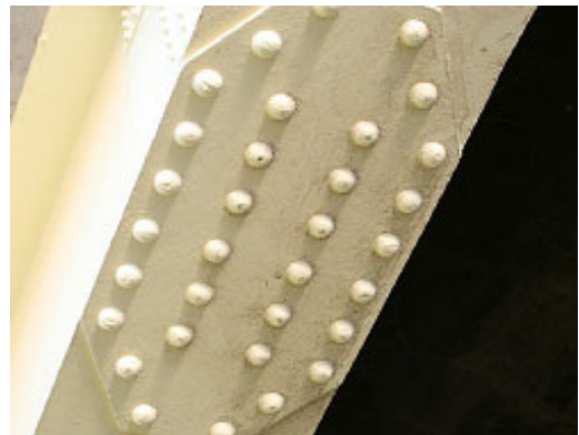
写真一6 ボルト継手部の状況写真 （「超厚膜」さび発生評価：0%）
