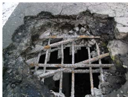
写真-1 コンクリート床版の抜け落ち
