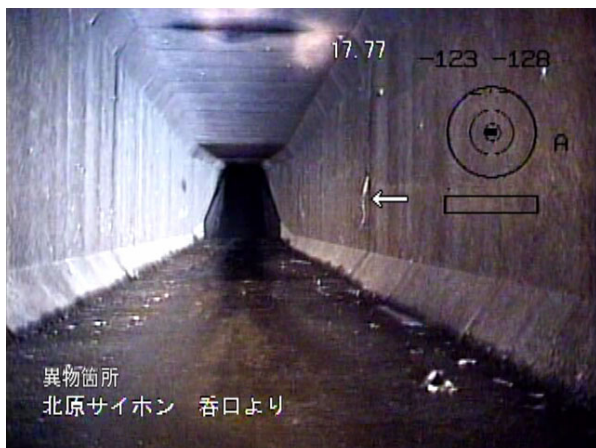
写真-3.1 自走ロボット残水無区間の調査状況 (Cサイホン内を直視した状況)
