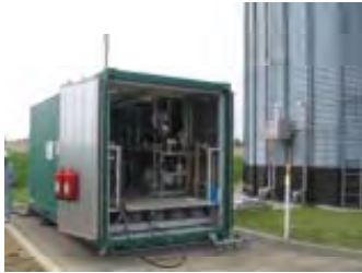
写真-1 バイオガス圧縮精製充填装置設置状況
