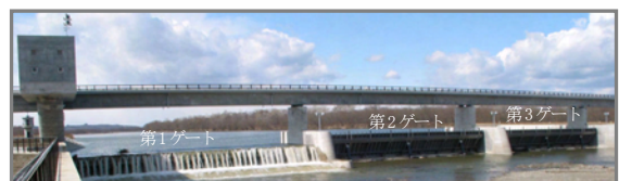
写真-3 千代田分流堰ゲート
