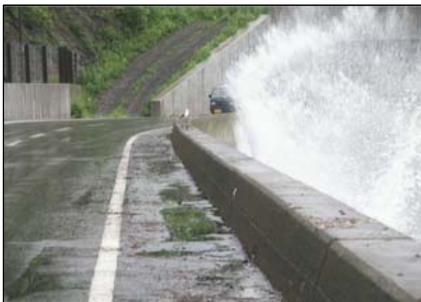
写真-1 海岸護岸からの越波状況と被害状況
