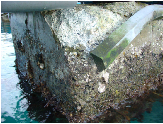
写真-2 劣化度III
