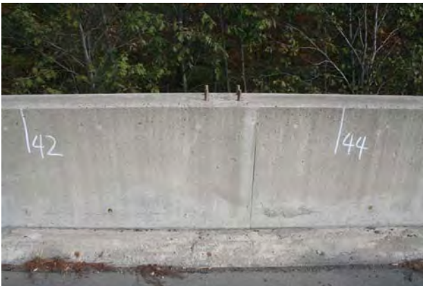
写真-6 スケーリング劣化状況(一般部・南向き)
