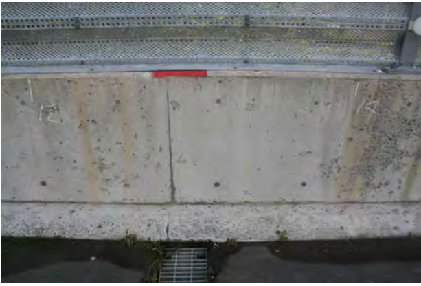
写真-4 スケーリング劣化状況(水みち部・北向き)
