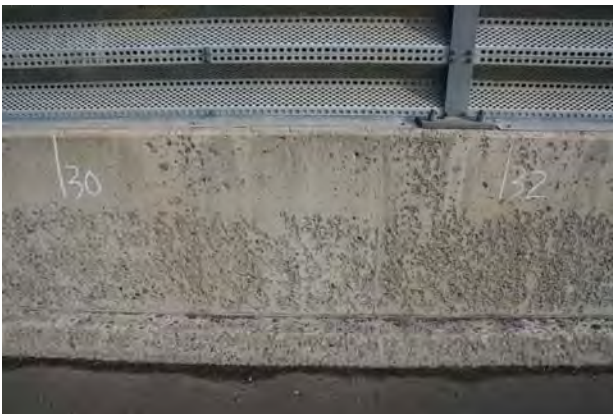
写真-5 スケーリング劣化状況(水みち部・南向き)
