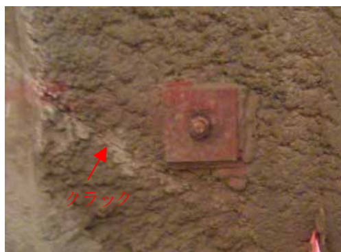
写-3 吹付コンクリートクラック状況写真
