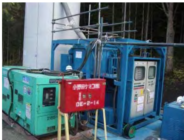
写真-5 プラント
