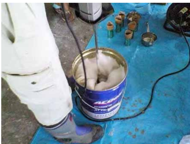
写真-3 起泡材混入状況
