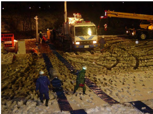
写真-1 平成19年浦幌町十勝太での内水排除
