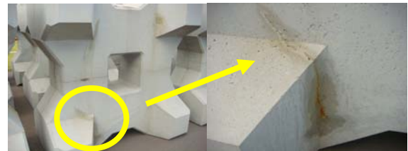
写真-3 ひび割れ
