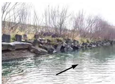
写真-1 洗掘による護岸の浮き上がり
