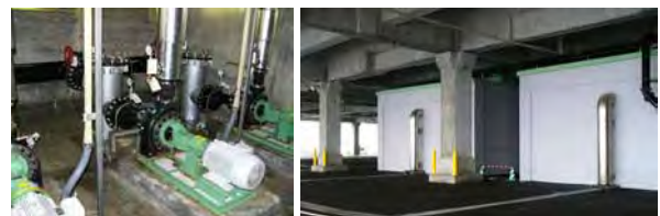
写真-4 取水ポンプ3基(水深 3.0m)と貯水タンク(900t/基×2基)
