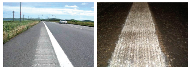
b) 前方不注意による路外逸脱対策としてのランブルストリップスの路肩への適用例(左)と切削型区画線(右)
