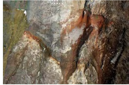
写真-6 H18.11 対策工施工前の状況
