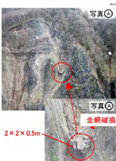
写真-8 ガマタ地区 H18.5 撮影 比高 150m 金網を破る落石 (2×2×0.5m)
