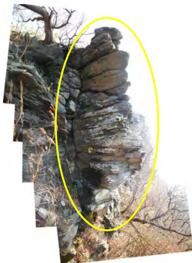
写真-3 火砕岩の浸食によりオーバーハングした玄武岩の不安定岩体（100m 3 程度）
