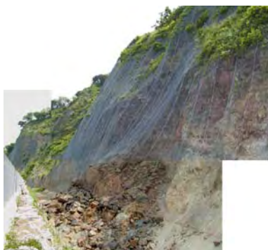
写真-1 H15.6岩盤崩壊状況（約300m 3 ）
