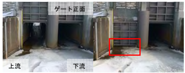
閉操作前(11:21) 閉操作後(11:27) 写真-1 鷓川 B 樋門：引上げ式ローラーゲート(H21. 2. 27) ※赤枠：不均一な結氷により生じた開口部
