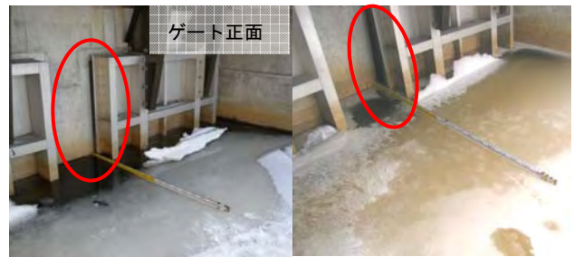
H21.2.9 H21.2.20 写真-13 釧路B樋門：自動開閉ゲート ※水位に応じてゲートが開閉している状況
