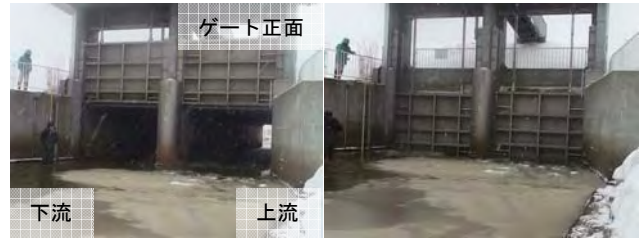
閉操作前(13:46) 閉操作後(13:47) 写真-12 釧路A樋門：引上げ式ローラーゲート(H21.2.20)
