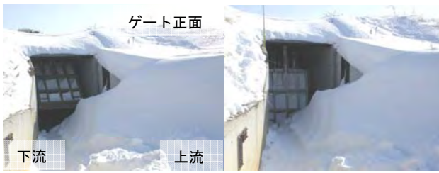
閉操作前(13:44) 閉操作後(13:48) 写真-10 十勝A樋門： 門柱レス油圧引上げ式ゲート(H21.2.23)
