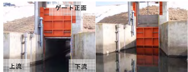
閉操作前(11:13) 閉操作後(11:20) 写真-3 沙流川 A 樋門：引上げ式ローラーゲート(H21. 2. 27)
