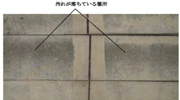
写真-7 洗浄後の供試体（B-2部拡大）
