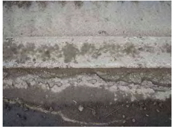
写真-22 舗装の破損状況
