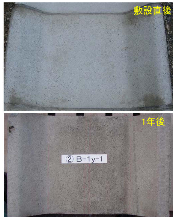
写真-4 即脱型の表面状況の経年比較
