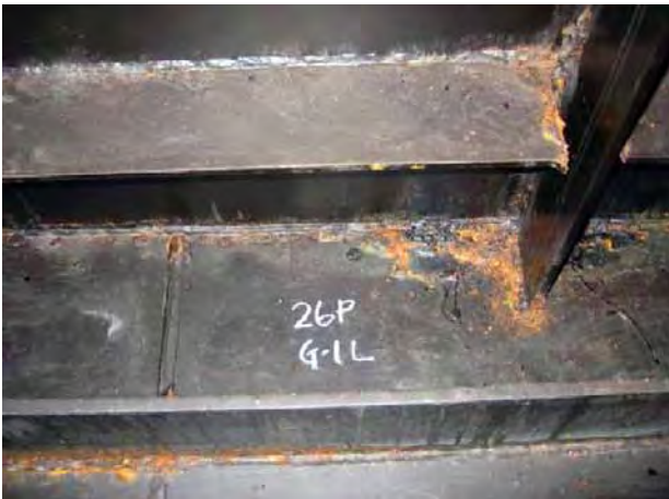
写真-3 桁内部の腐食状況
