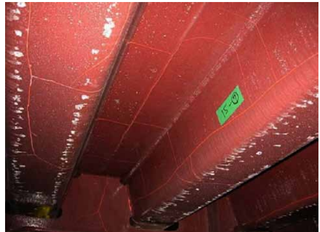
写真-4 塗装のひび割れ状況
