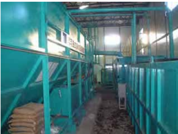
写真-3 濁水処理施設状況(H20.12月)
