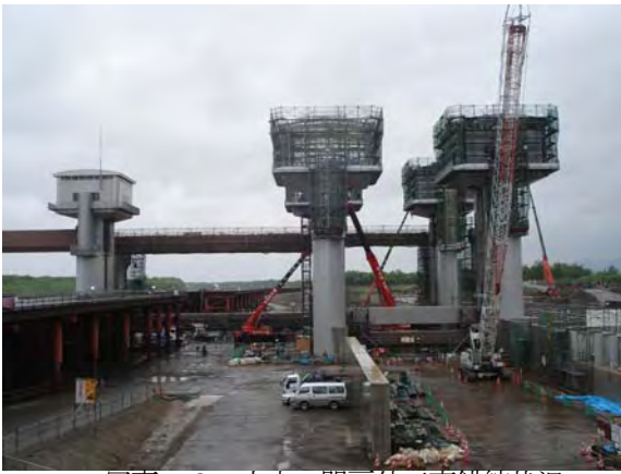
写真－6 土木・門扉外工事錯綜状況
