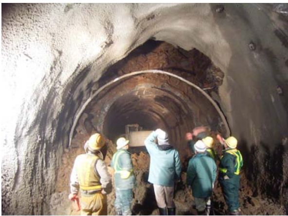
写真-4 大規模な高抜け部状
