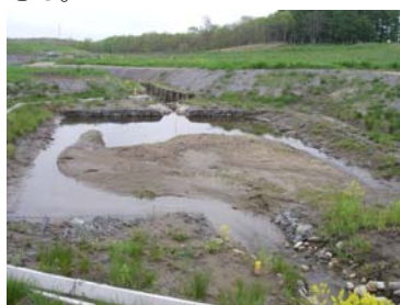
写真-5 第七川1号排水路排水調整池の堆砂状況
