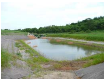
写真-4 第七川排水路遊水池
