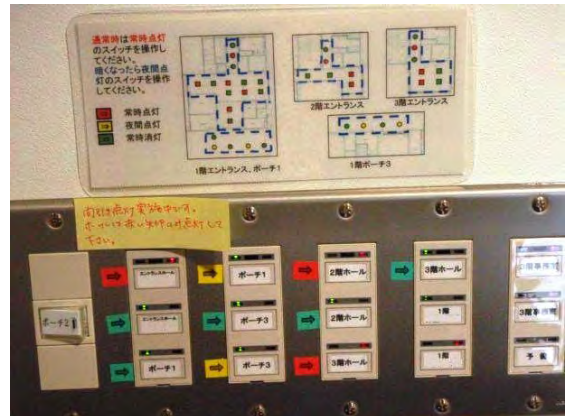
写真-6 照明間引き点滅区分を表示した事例
