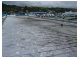
写真-6 屋根面糞害
