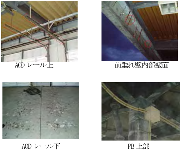
写真-7 内部鳥害状況
