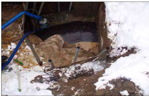
写真-4 鉄鋼系管材外面状況 (A地点)
