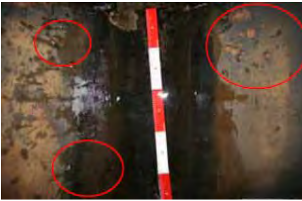
写真-2 鉄鋼系管材発錆状況 (A地点底部)
