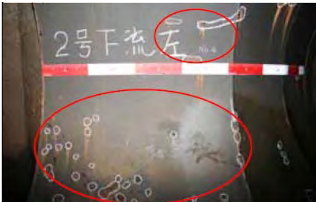
写真-3 鉄鋼系管材発錆状況 (B地点側部)
