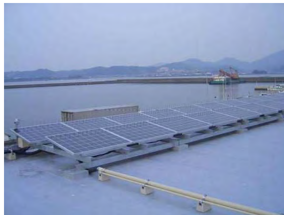
写真-1 荷捌施設屋上の太陽光パネル
