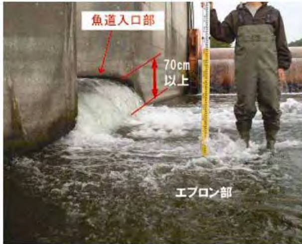
写真-3 真勲別頭首工魚道入り口の状況
