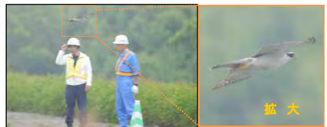
(工事作業員の側を通過して採餌に向かう(手前側で大型重機稼働)) 写真-1 工事実施中の本路線上に出現したオオタカ
