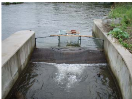
写真-1 トラップ設置状況
