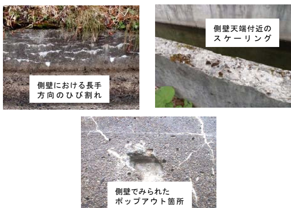
写真-1 水路における凍害劣化の形態
