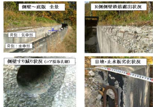
写真-7 劣化状況
