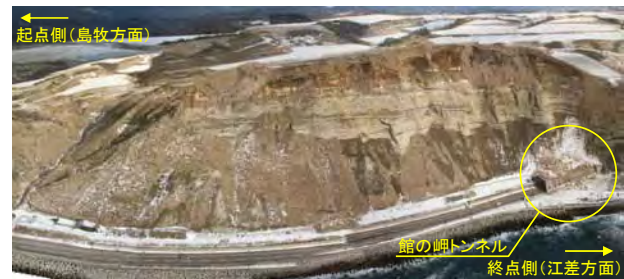
写真-1 被災箇所全景写真
