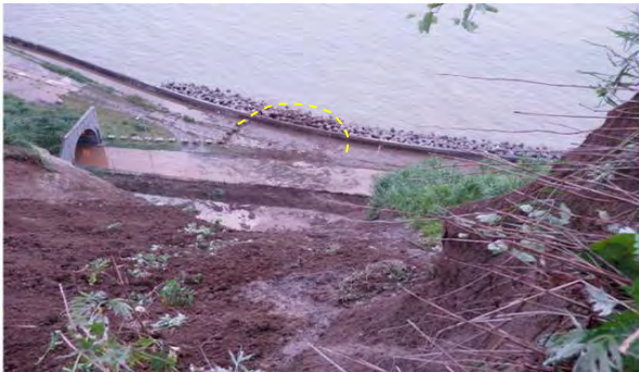
写真-3 崩壊箇所から現道を望む (8月12日撮影)
