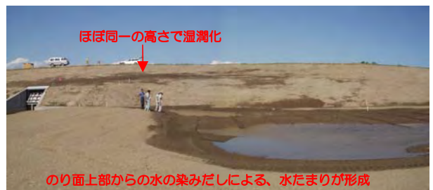
写真-5 冬期施工により築造された樋門周辺において発生した変状の一例
