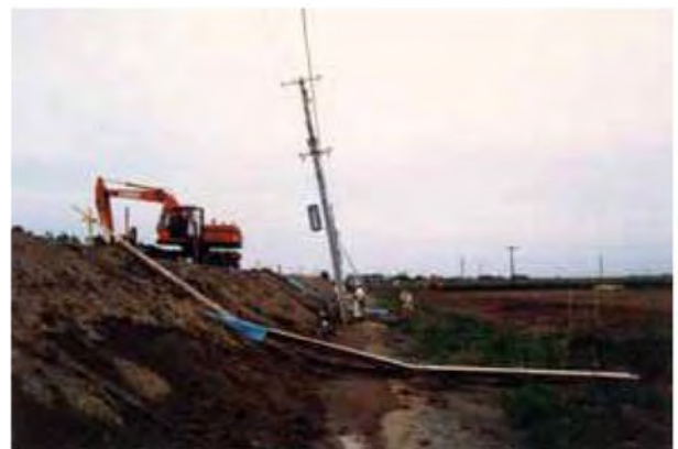
写真-3 地盤の側方流動による電柱の傾斜（「泥炭性軟弱地盤対策工マニュアル」より引用）
