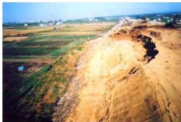
写真-2 泥炭性軟弱地盤における盛土崩壊（「泥炭性軟弱地盤対策工マニュアル」より）
