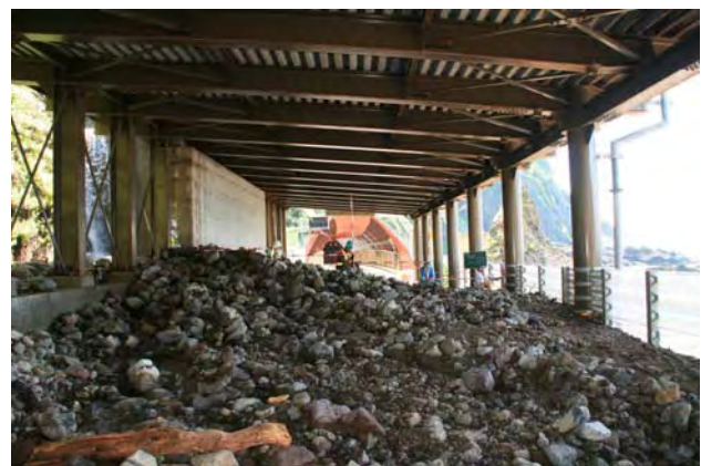
写真-2 被災状況（島牧村持田穴床前覆道内の土石堆積状況）
