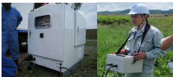
写真-4 操作盤及びコントローラ
