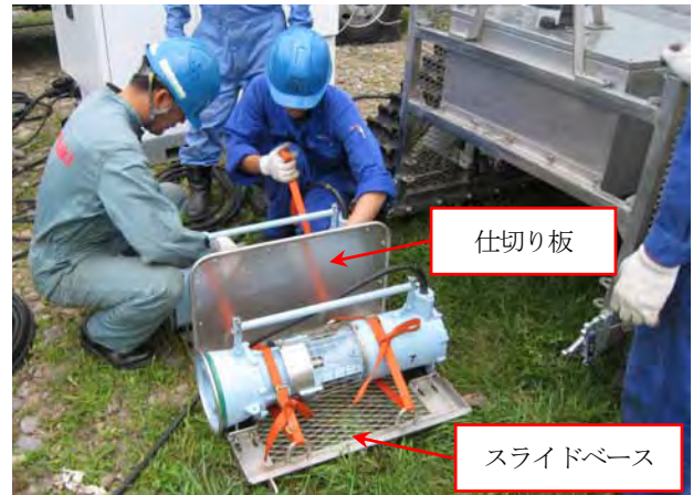
写真-8 排水ポンプ搭載状況
