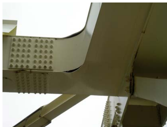
写真-2 橋門構隅角部の局部座屈
