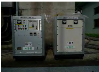
写真8 直流高圧電源装置
