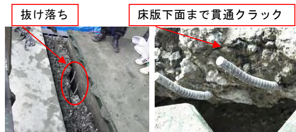
写真12 伸縮装置破砕状況
