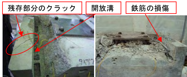
写真11 支承破砕状況
