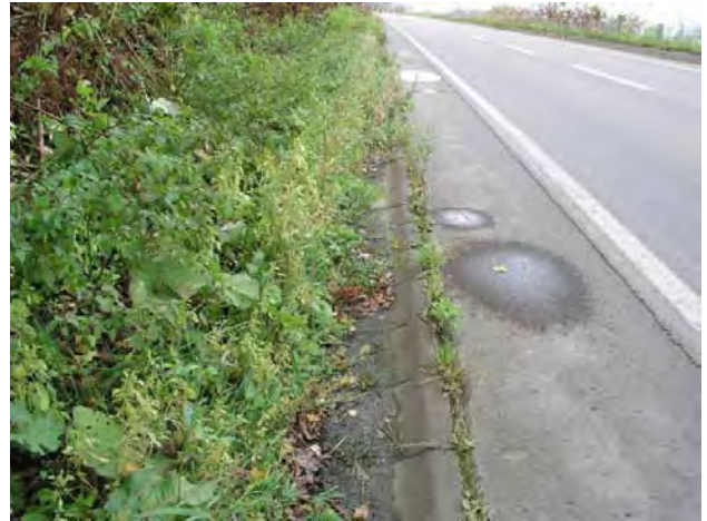
写真-19 皿形側溝雑草繁茂状況
