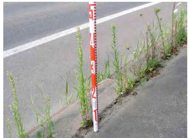
写真-1 縁石上部の雑草の繁茂
