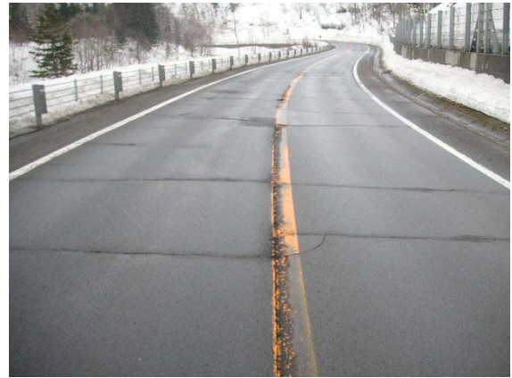
写真-3 低温ひび割れ
