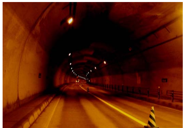
図-7 基本照明の不点灯
