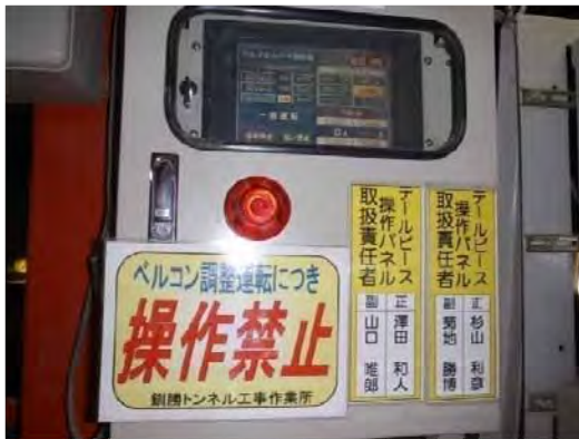
図-8 試運転・点検・整備時の明示状況
