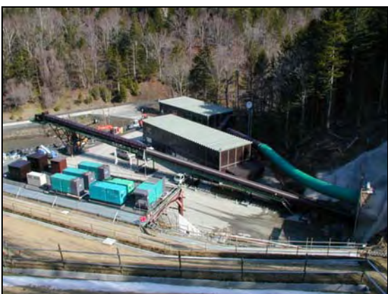
図-6 坑外ベルトコンベア全景
