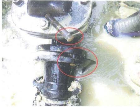
写真2 ボルト・ナット損失状況
