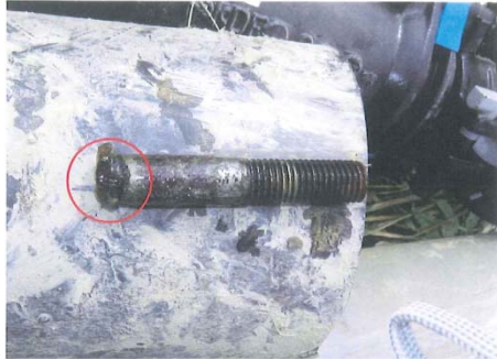
写真3 ボルト頭損失・腐食状況
