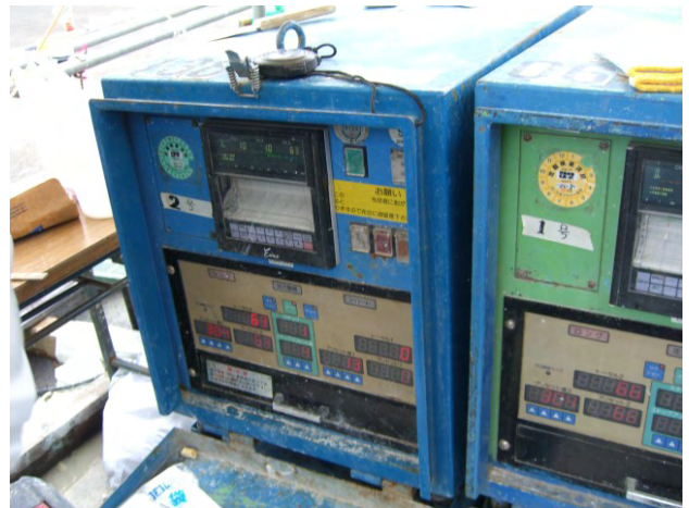
写真-7 流量計機器の状況
