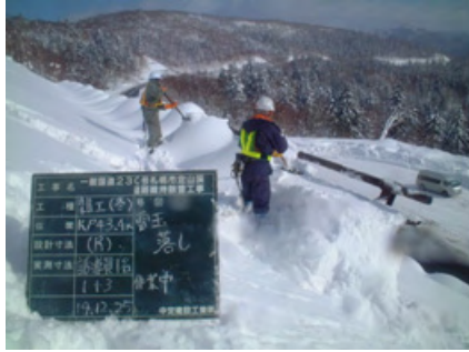
写真-4 雪崩予防柵上の雪玉落とし状況
