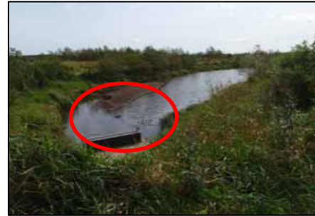
写真-4 遊水池の堆砂状況
